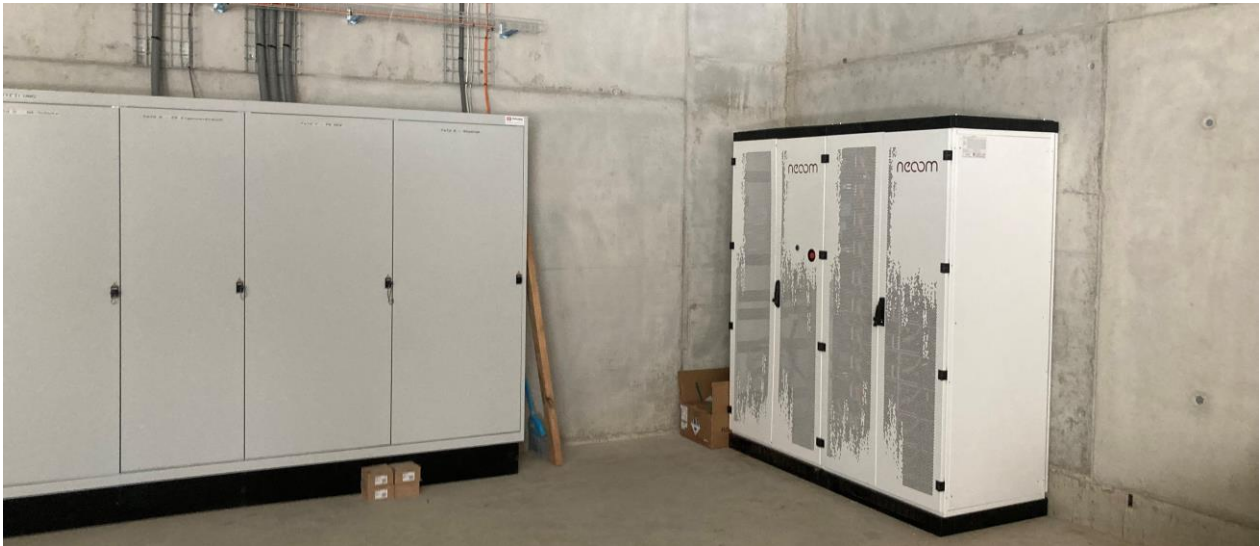
Dieser Batteriespeicher mit einer Kapazität von 99.5kWh wurde mit einem Bundes- und Kantonsbeitrag unterstützt (Foto zVg).
